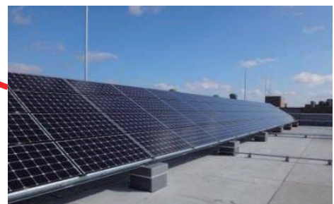
図 3-114 太陽光発電パネル
