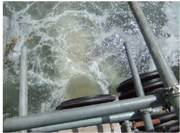
図 3-85 多賀城緩衝緑地公園内 緊急放流状況
