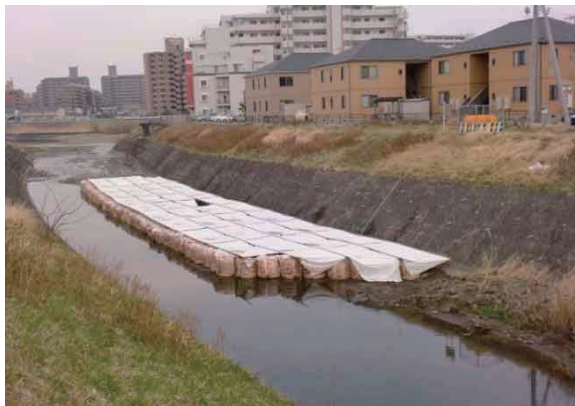
図 3-86 要害川 仮設沈殿池
