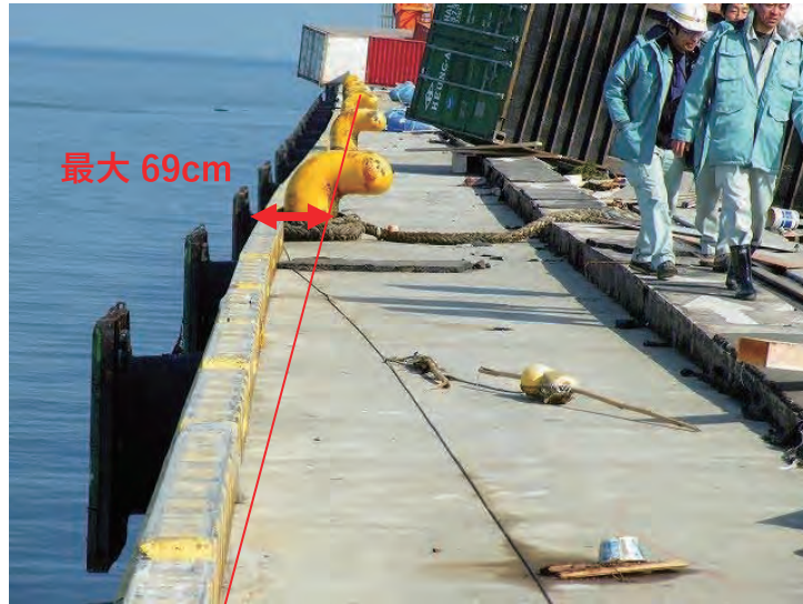
図 3-10 岸壁法線のはらみだし
