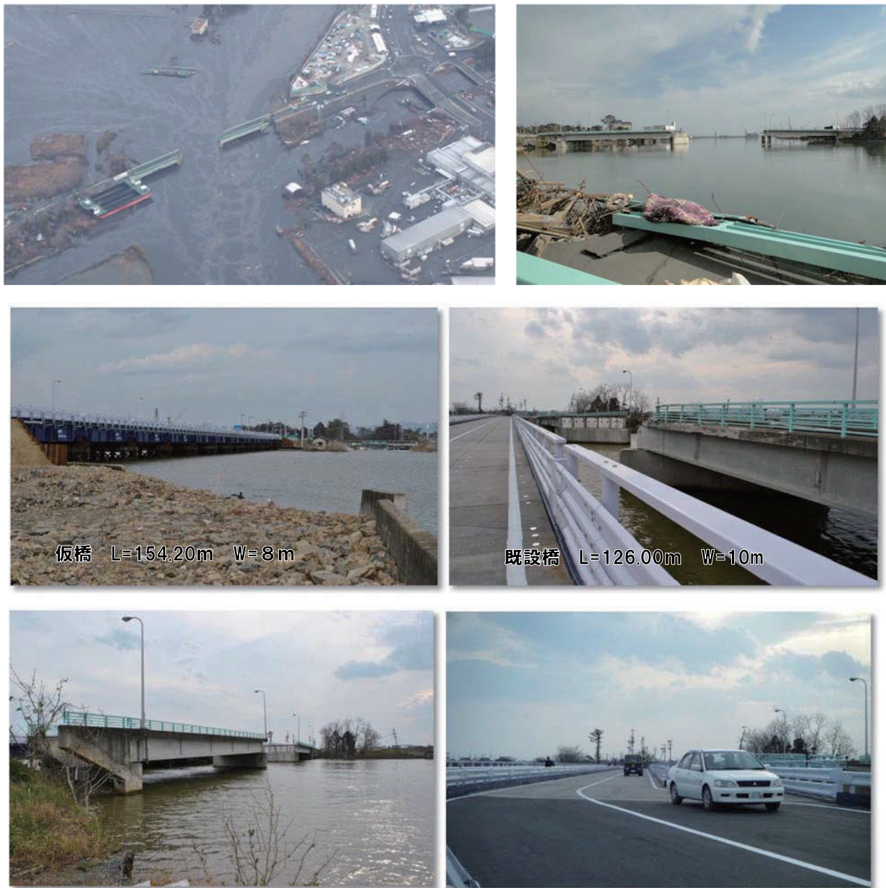
図 3-9 定川大橋の被災状況と仮橋による応急復旧
