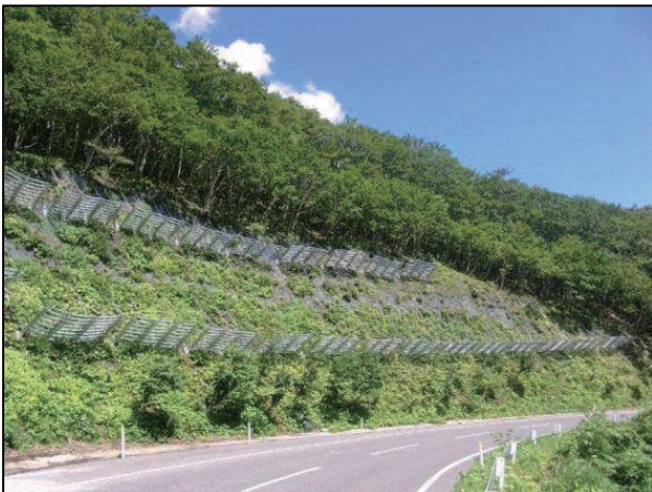
図 3-16 国道 347 号 外川工区雪崩防止柵
