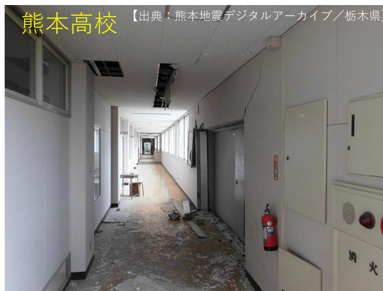
平成28年熊本地震時の被害状況
