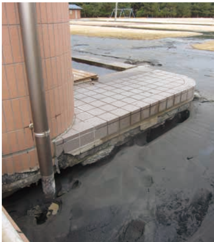
沿岸部では地震発生直後に液状化や地盤沈下が見られた。
