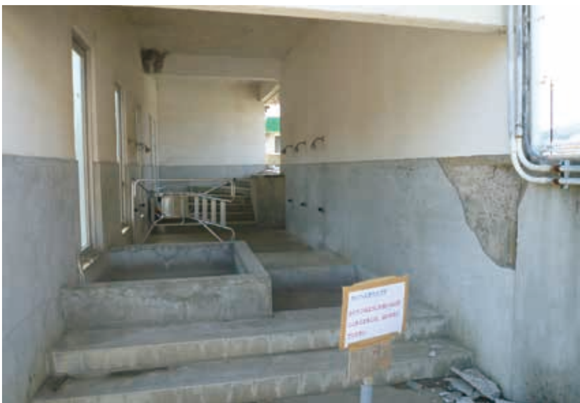
施設壁面に被害を受けた逢隈中学校。 平成23年4月撮影
