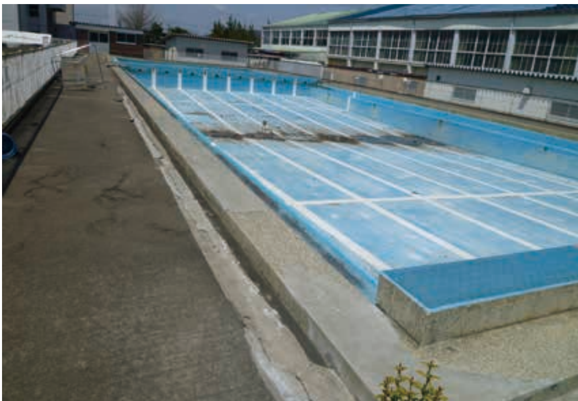
プール施設内にひびが入った逢隈小学校。 平成23年4月撮影
