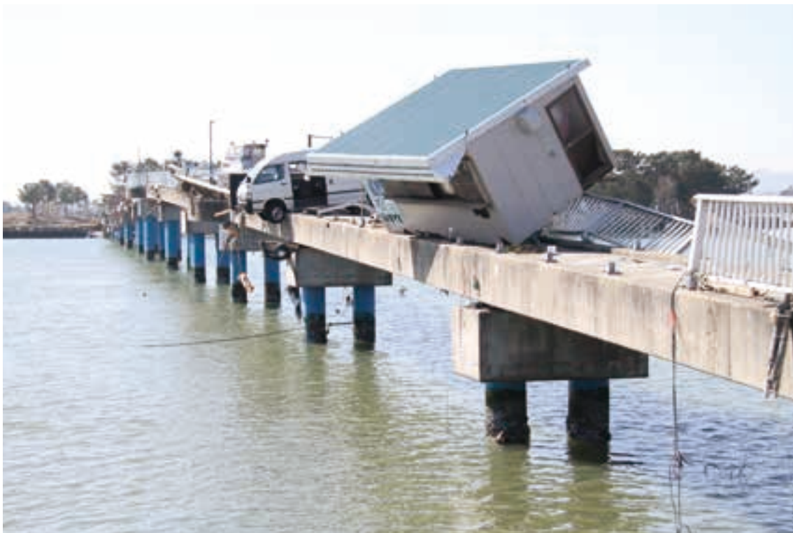
津波の猛威から橋上にはワゴン車等が打ち上げられた。 (海浜の森へと続くマリンレインボーブリッジ)
