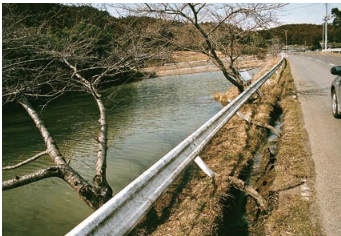
逢隈小山地区の被害。
