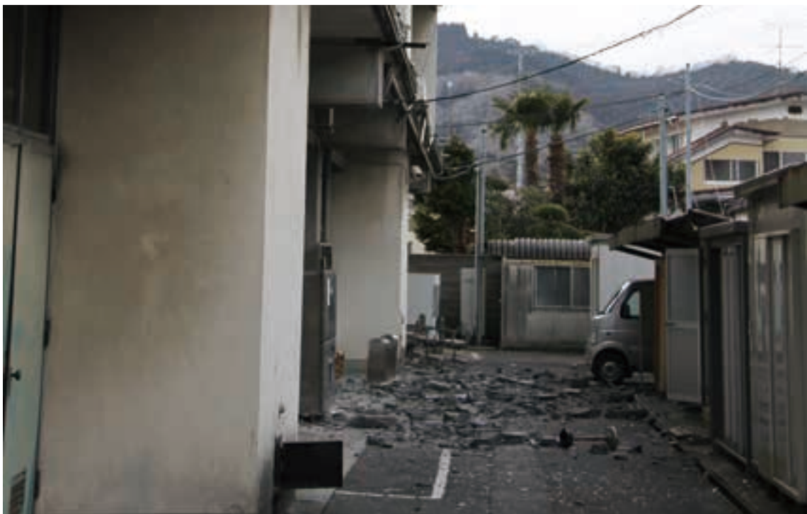
役場庁舎北側屋上部分のコンクリートが剥がれ落下。
