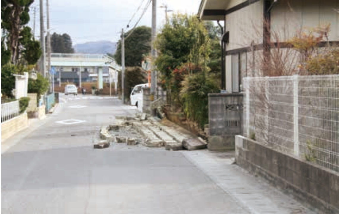
揺れで倒れたブロック塀。
