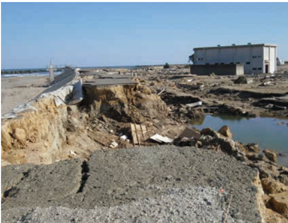
津波によってえぐり取られた道路。(荒浜五丁目阿武隈川河口付近の堤防)
