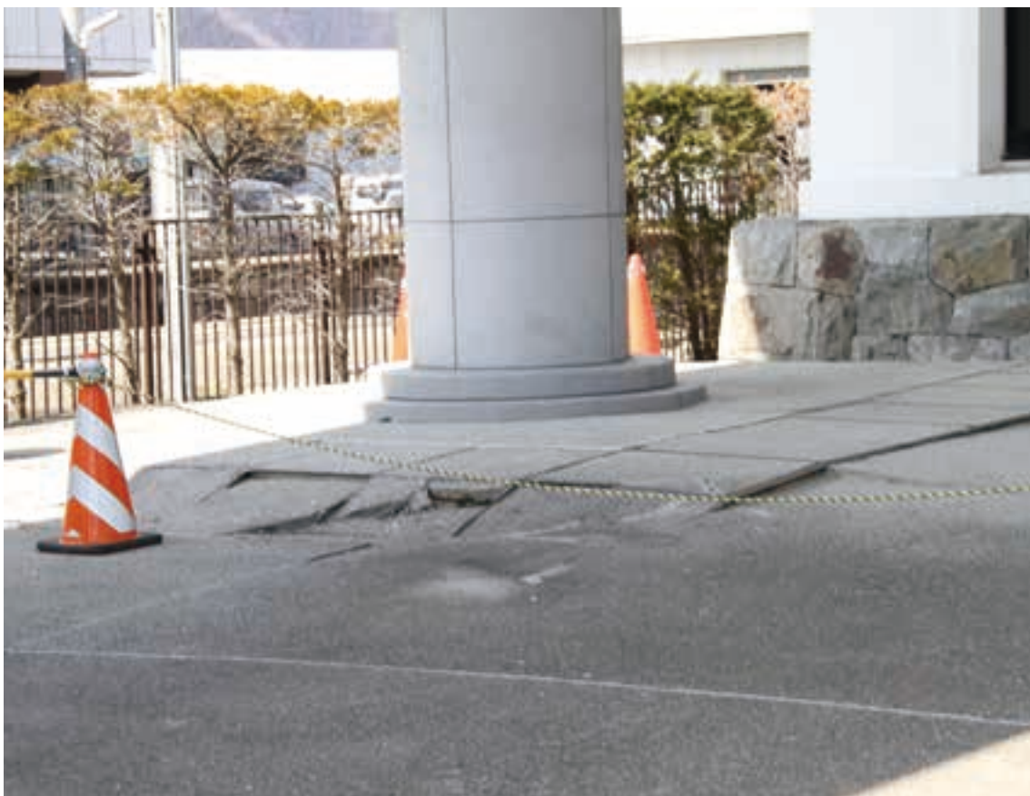
内陸部でも、地震による地面の隆起が見られた。(悠里館)
