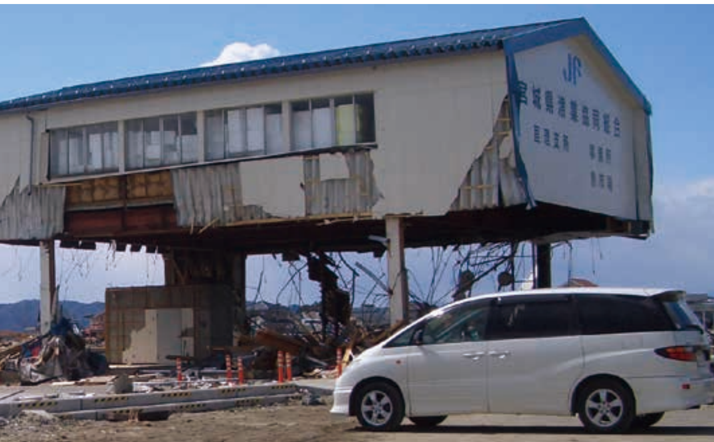
1階部分の柱があらわになった「宮城県漁業協同組合 亘理支所」。
