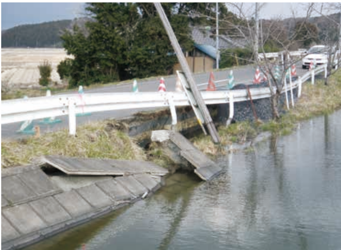
側道が崩れ落ちガードレールが大きく歪んだ。(町道上郡小山線 梅ノ原ため池法面) 平成23年3月撮影
