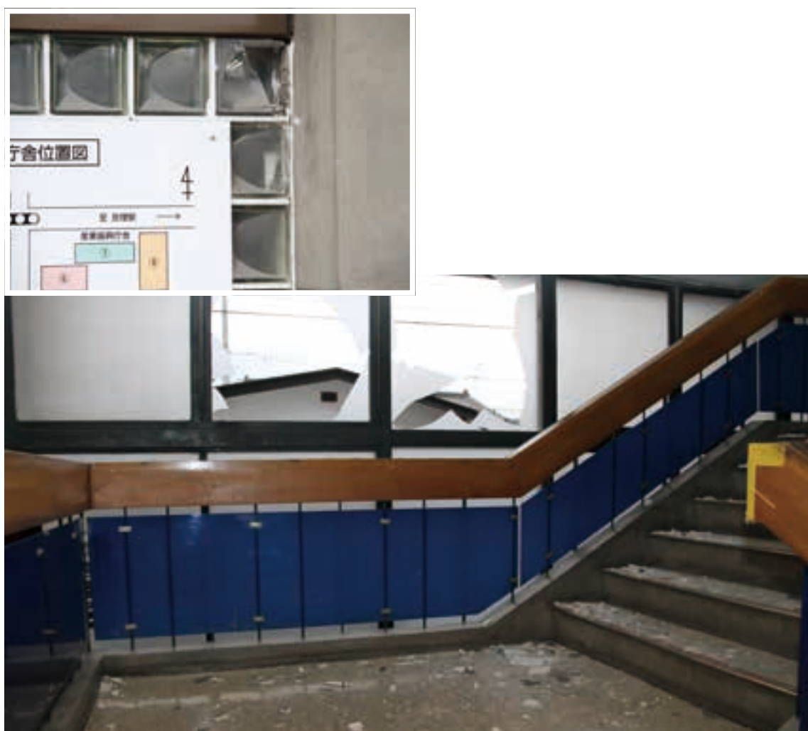
巨理町役場庁舎もガラスが割れるなどの被害に見舞われた。
