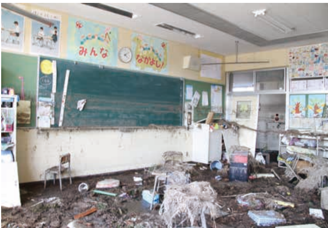
津波襲来後の痕跡が残る長瀬小学校の教室。
