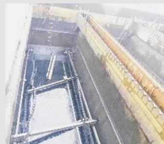
令和4年3月污泥掻寄機脱落
