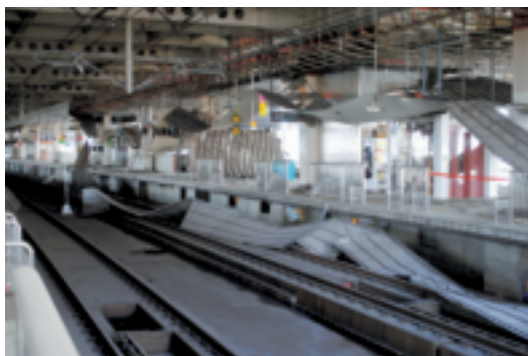
JR 仙台駅新幹線ホームの天井落下
