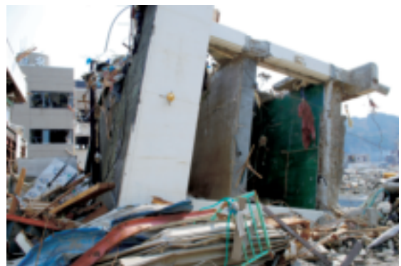
津波により横倒しになった鉄筋コンクリート造2階建ての女川交番（県警察本部）
