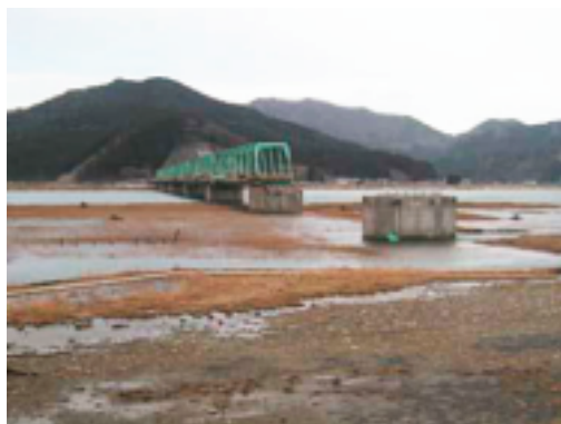
流出した北上大橋
