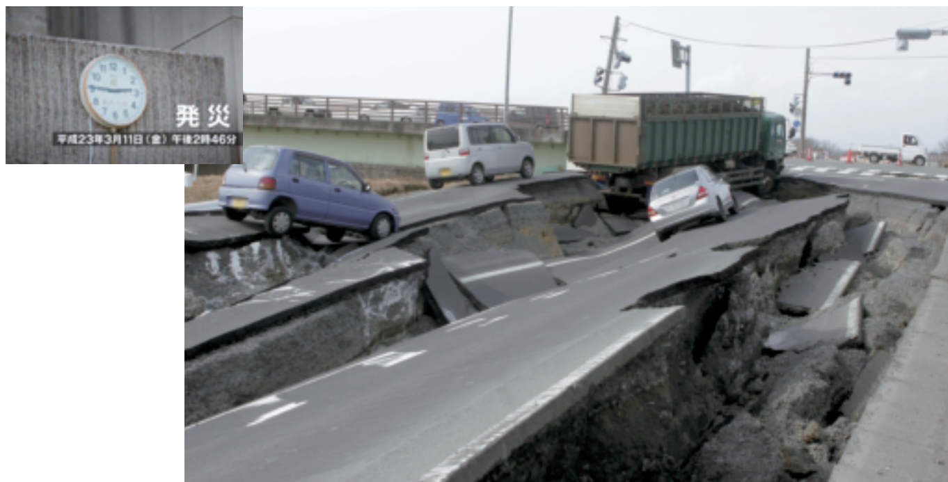
3月11日 大崎市古川江合橋付近 崩落する道路（大崎市）
