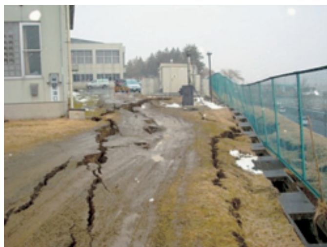
3月11日 大和町立大和中学校裏のり面の亀裂（大和町）
