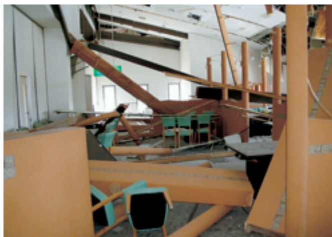
建物内の被害（大郷町）
