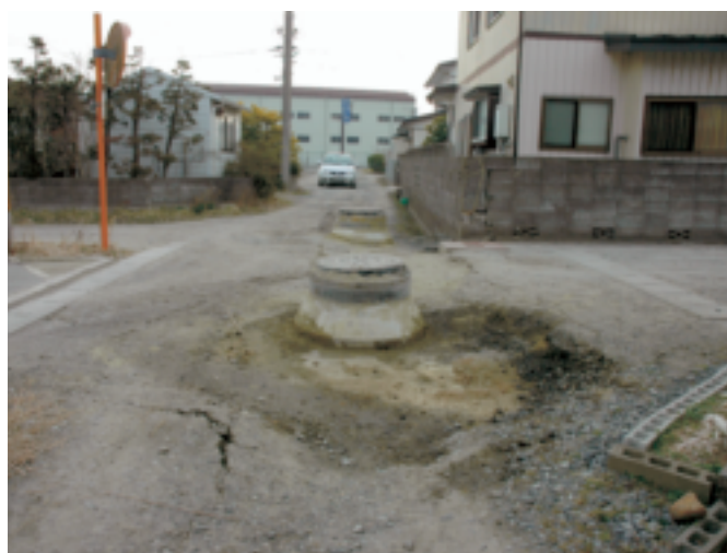
道路の陥没により浮上したマンホール（美里町）
