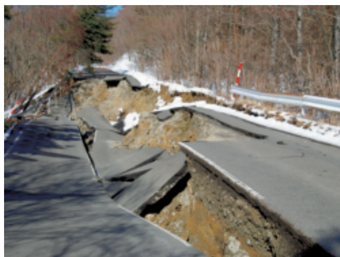
道路の崩落（七ヶ宿町）
