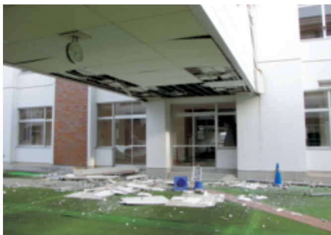
利府町立しらかし台小学校の施設被害（利府町）
