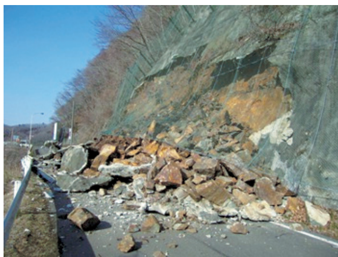
川崎町大字支倉地内 道路のり面の崩落（川崎町）
