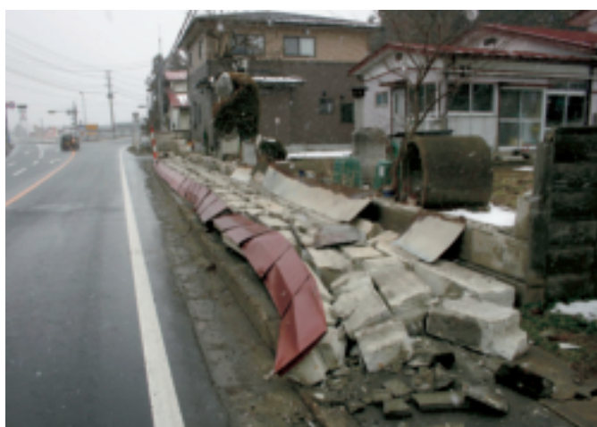
ブロック塀の倒壊（加美町）
