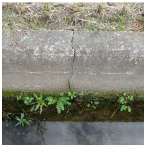
縦方向のひび割れ
