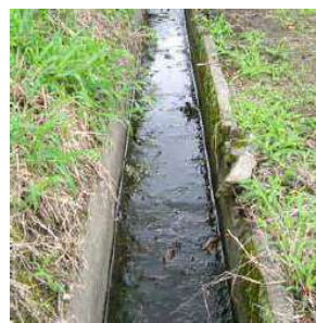
部分的な欠損
