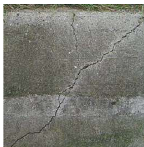
斜め方向のひび割れ
