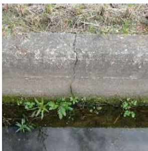
縦方向のひび割れ
