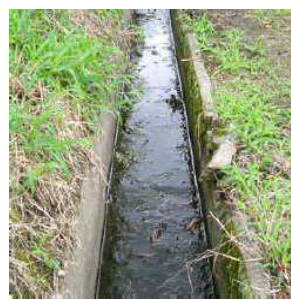
部分的な欠損
