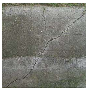
斜め方向のひび割れ
