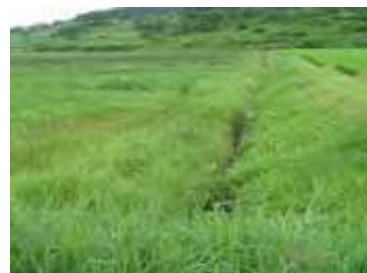
雑草の繁茂状況
