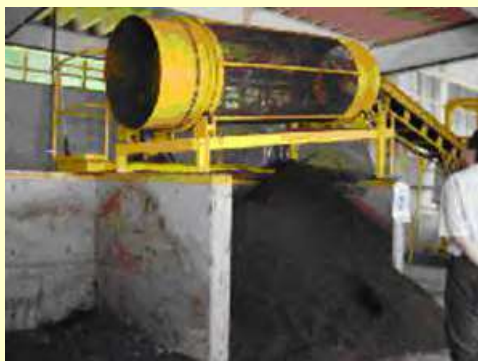
堆肥プラント
