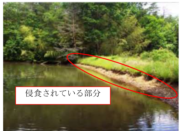
侵食が生じているため池堤体
