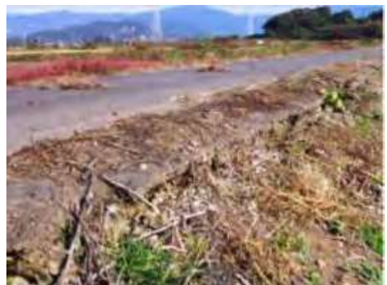
路肩の浸食と路面下の空洞
