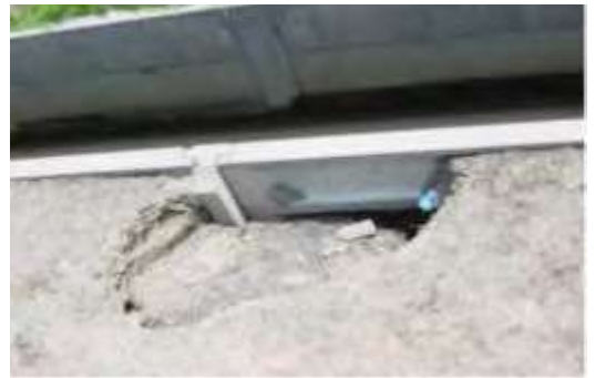
水路側壁の空洞状況
