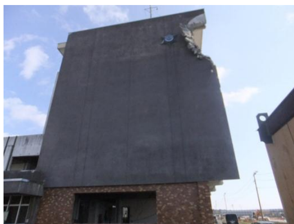
冷凍工場がぶつかった4階壁面
