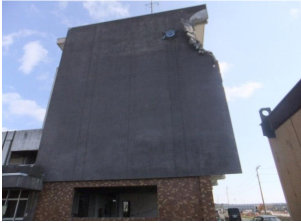
冷凍工場が激突した南校舎壁面
