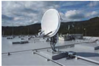
衛星回線用アンテナ
