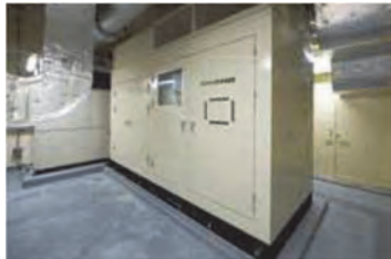
非常用自家発電機
