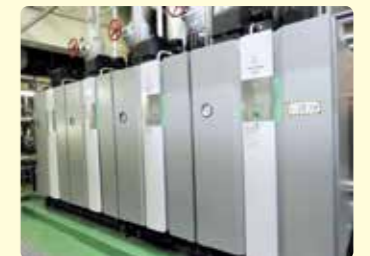
導入された高効率ボイラ
