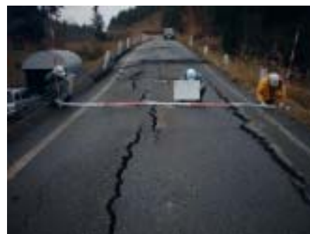
災害復旧事業の申請のため道路の被災状況を調査しました。
