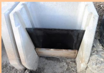
【田んぼダム対応排水柵・堰板】
