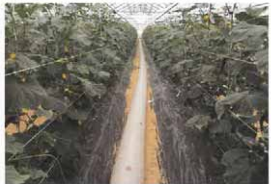
炭酸ガス施用(中央のダクト)
