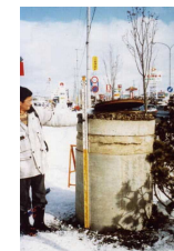
マンホールの浮き上がり
