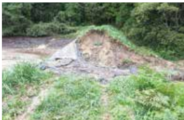
決壊した農業用ため池(白石市)
