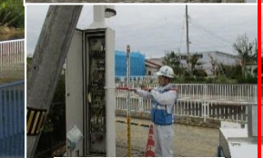
制御盤内浸水状況
