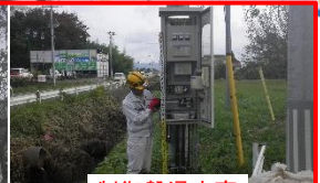
制御盤浸水高
