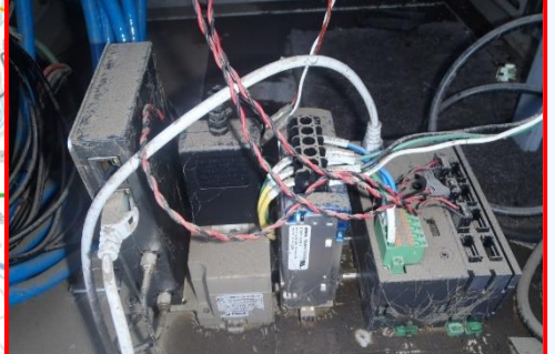
制御盤内浸水状況
