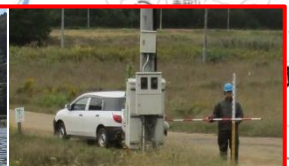
制御盤浸水高
