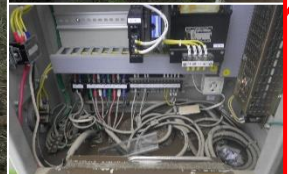
制御盤内浸水状況
