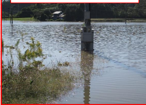
村田町沼辺地区 汚水マンホールポンプ
