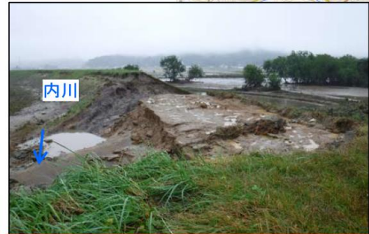
内川: 堤防決壊 (宮城県丸森町 二本木～不動 地先)
