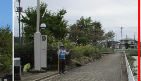
制御盤浸水高
