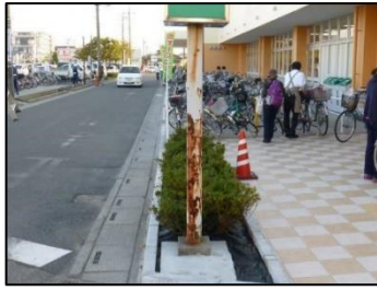
支柱の腐食が進行した状態
