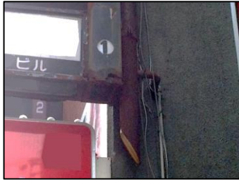
支持部が腐食した状態
