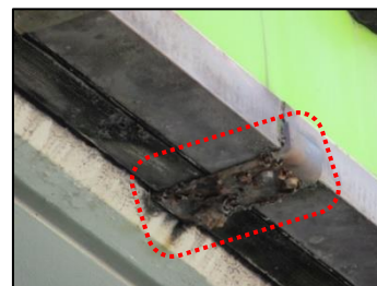
金具が劣化した状態
