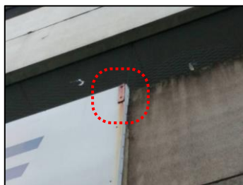
金具が劣化した状態
