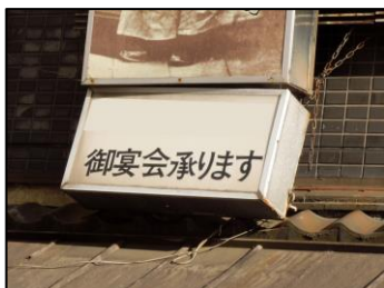
屋外広告物本体の傾き
