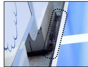
コーキングが劣化した状態
