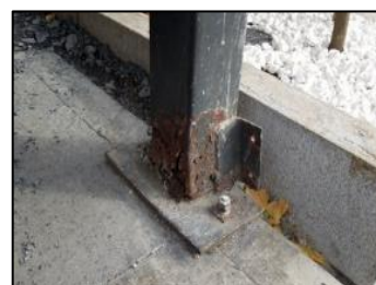
支柱根元の腐食が進行した状態
