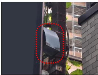
ブラケットカバーが外れかかった状態
