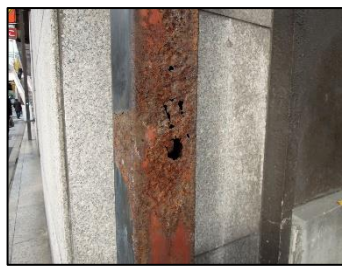
支柱の腐食が進行した状態
