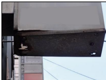
側板底面が腐食、破損、変形した状態
