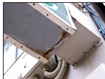
側板底面が破損した状態
