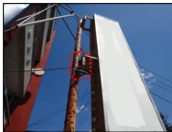
支柱・広告板接合部の腐食・隙間
