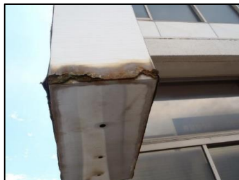
側板の腐食が進行した状態
