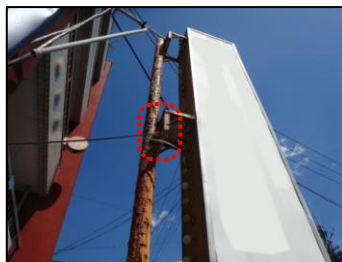
支柱・ブラケット接合部が腐食した状態
