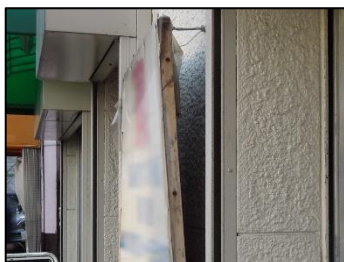
壁面との間に隙間が生じた状態
