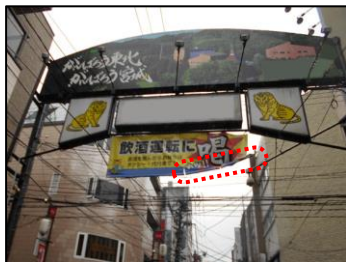
幕材を張る部材が破損した状態
