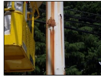
その他（支柱の腐食など）
