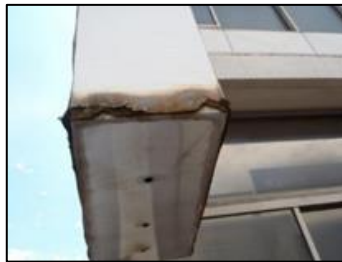
広告板底部の腐食
