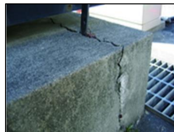
基礎にクラックが入った状態
