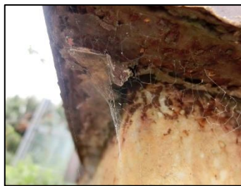
支柱・広告板接合部の腐食が進行した状態
