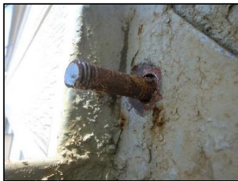
アンカーボルトのさびが進行し、ネジ山が欠損した状態
