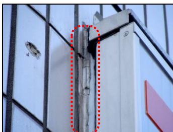
広告板と壁面との隙間のコーキングが劣化した状態
