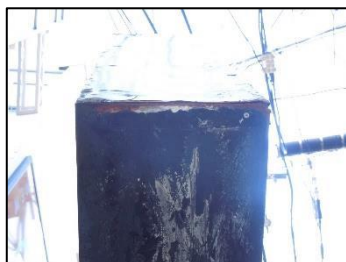
側板底面にさびが発生した状態
