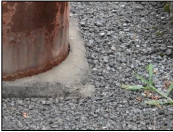
屋外広告物本体の傾き
