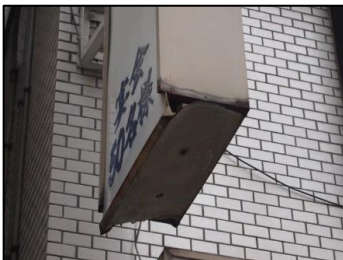
その他 （塗装剥離，腐食など）
