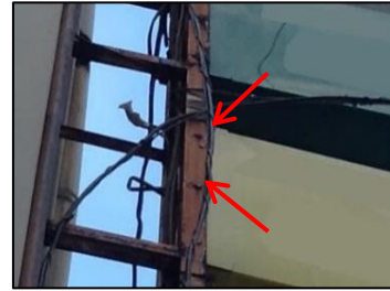
ボルトのゆるみや欠落した状態
