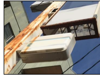
支柱にさびが発生した状態
