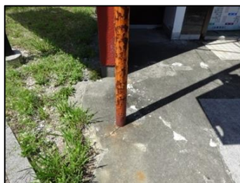
支柱の腐食が進行した状態
