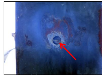
水抜き孔の詰まり
