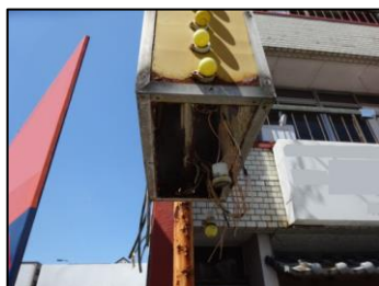
側板底面が欠損した状態
