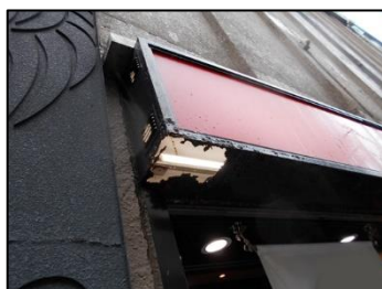
側板底面の腐食が進行した状態
