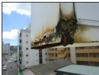
側板の腐食が進行した状態
