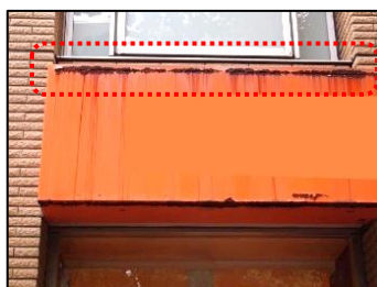
その他（塗装剥離，腐食など）
