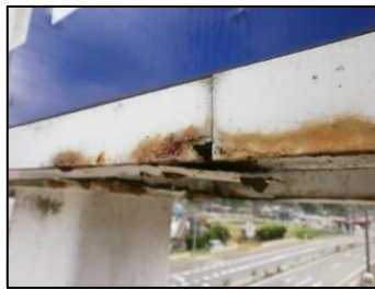
その他（塗装剥離，腐食など）
