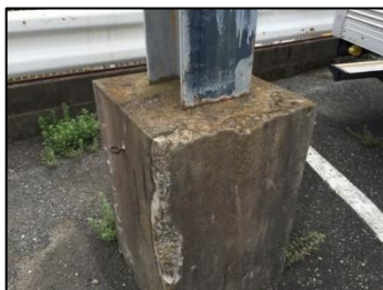
根巻きコンクリートが劣化し、欠けた状態
