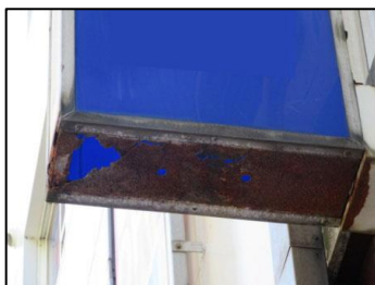
側板底面が腐食、破損した状態
