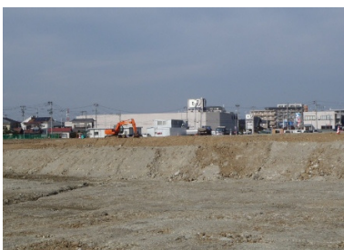
仙台市荒井西地区 防災集団移転促進事業 災害公営住宅整備事業
