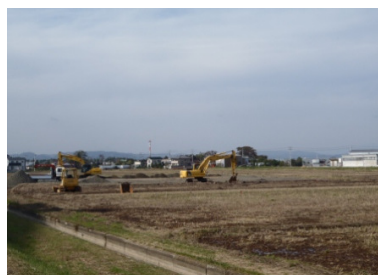
名取市下増田地区 防災集団移転促進事業 災害公営住宅整備事業
