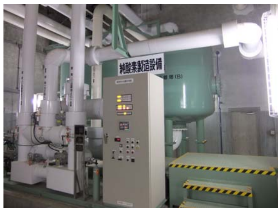
(純酸素製造設備)
