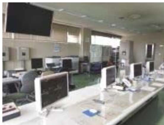
(中央監視制御装置)
