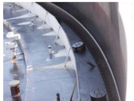
図 2.5.5 ポンツーン蓋の離脱
