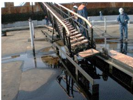
図 2.5.2 ローリンググラダーの脱輪
