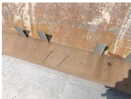
図 2.5.4 ウエザーシールのはずれ
