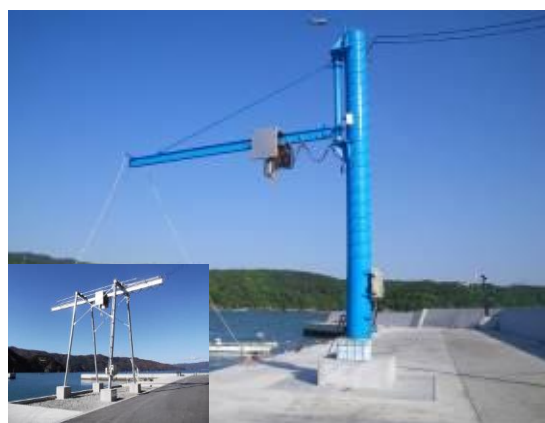
荷揚クレーン
