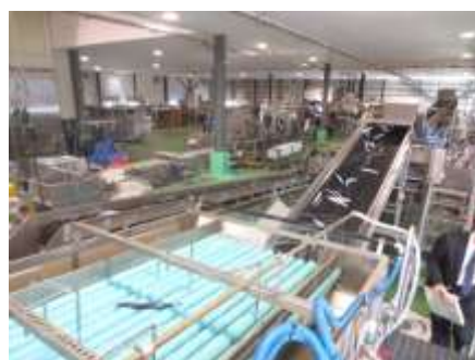
復旧した水産加工設備（冷凍魚製造ライン）
