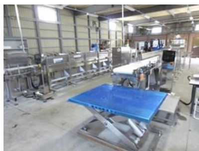
石巻魚市場に設置されている連続個別非破壊放射能測定システム(簡易検査用)
