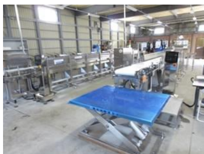
石巻魚市場に設置された連続個別非破壊放射能測定システム(簡易検査用)
