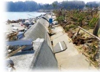
被災した防潮堤と海岸林
