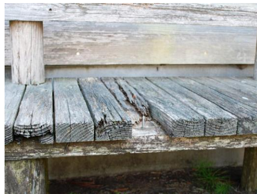
腐朽により座面が破損したベンチ 雨がかりの環境におかれたため腐朽が進んでしまいました
