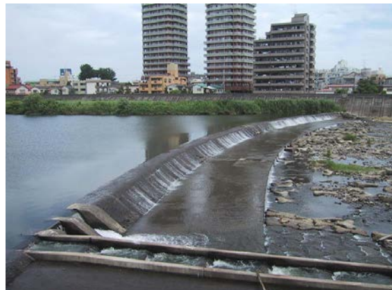
放流後 郡山堰の状況(H16.8.4 11:30頃) (広瀬橋地点 h=-0.98m 、 Q=1.68m^3/s )
