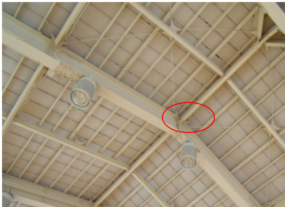
体育館天井筋違 曲がり・外れが発生
