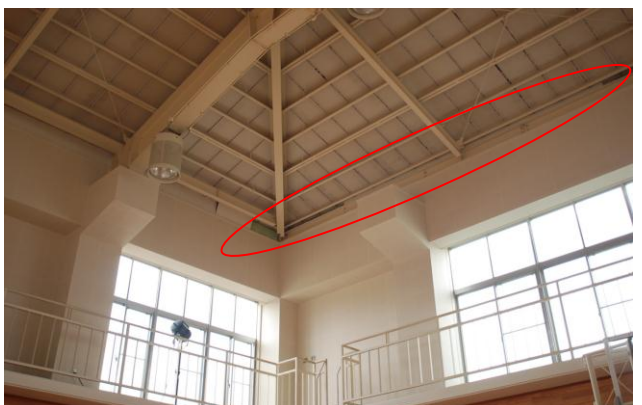
体育館上部壁 石膏ボードが脱落した
