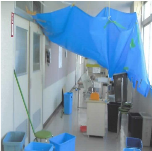
校舎3F 生物室前廊下天井裏給水管破損
