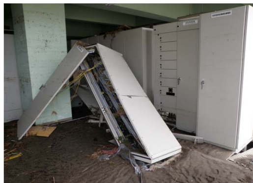
電気設備被災状況
