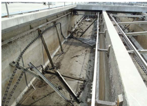
最終沈殿池被災状況
