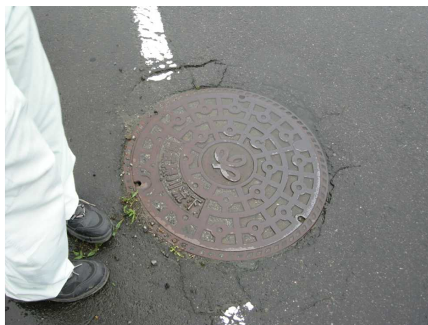
マンホール周囲の亀裂状況
