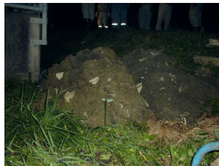
管渠に貯留していた土砂・し渣
