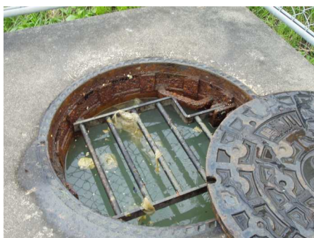
管渠の閉塞によりマンホールに汚水がたまっている状態
