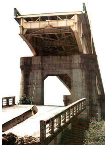
昭和53年の宮城県沖地震による落橋
