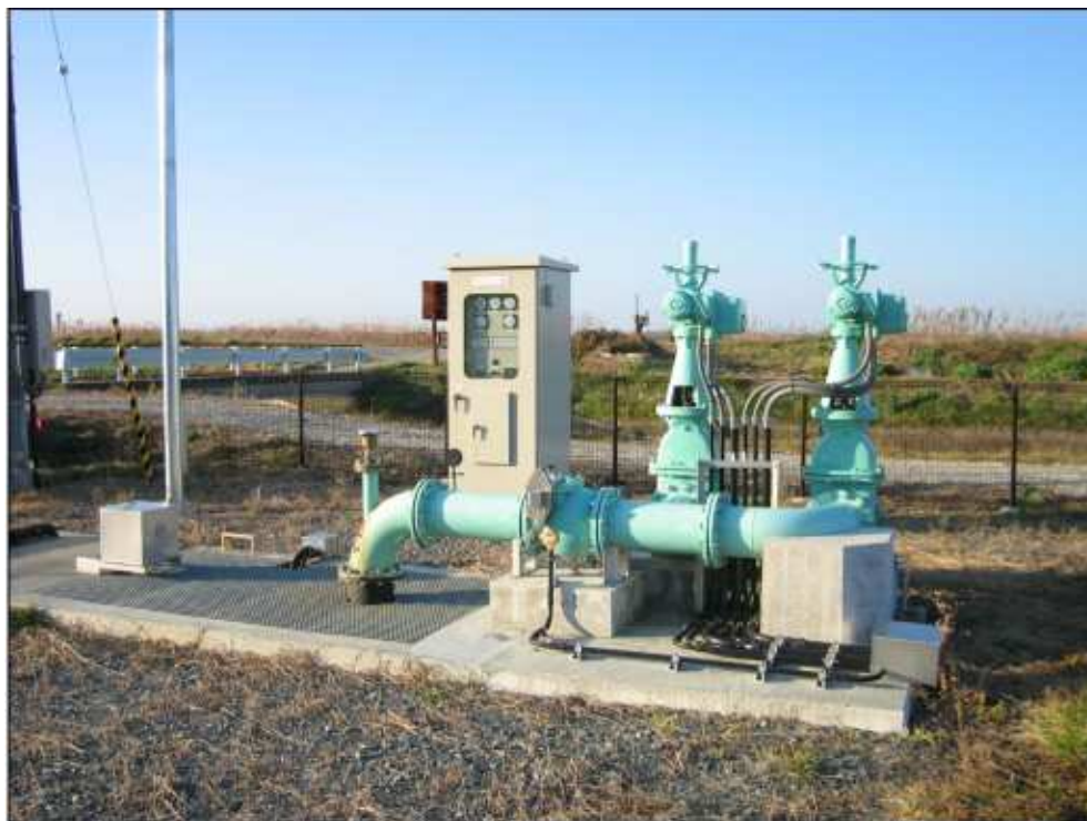
揚水機場(区画整理後)
