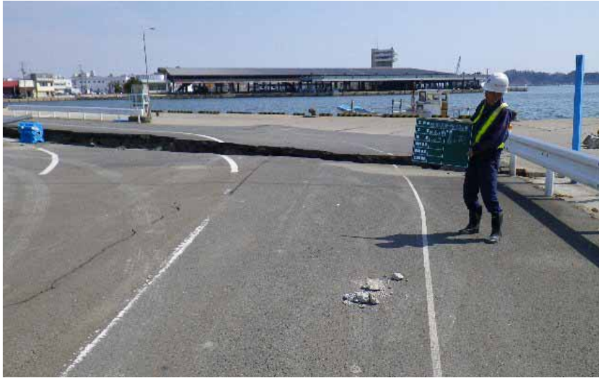
応急復旧(被災状況)
