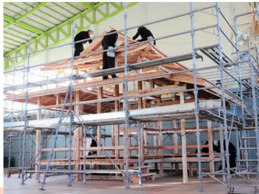
木材の加工から組立作業を通し実物大家屋を建築します
