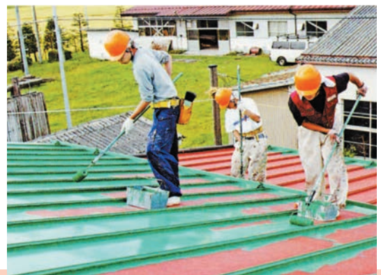
屋根の塗り替え作業で、ローラー塗りの訓練を行っています
