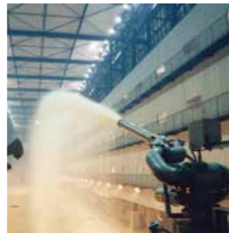
放水銃の性能テストの様子。放水銃は、ドーム型スタジアムや空港・体育館などの大型の建物に設置されています
