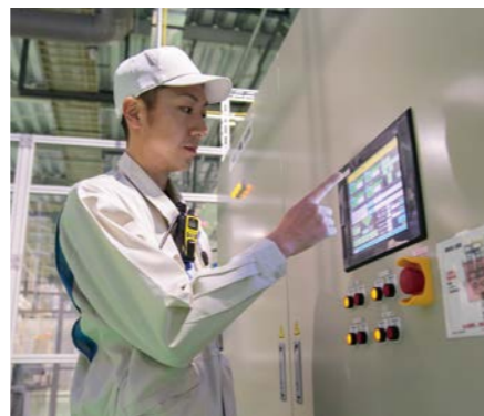
装置の液晶モニターに表示されているパラメーターを確認し、運転状況をチェックする
