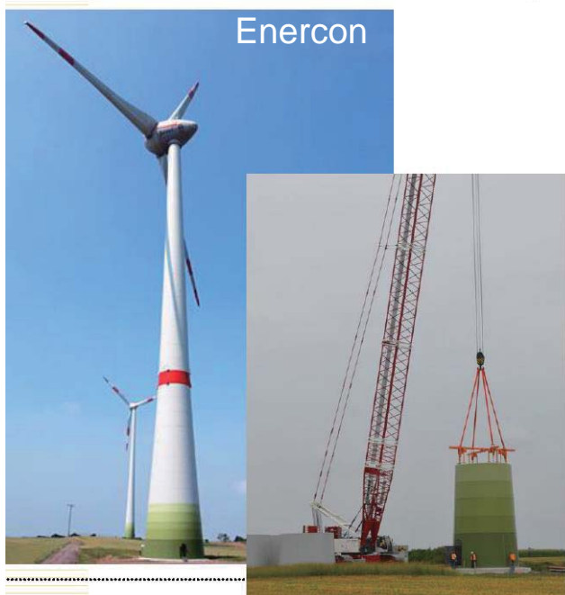
(プリキャストコンクリートタワー)
