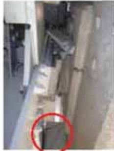
写真-6 支承の破損の状況
