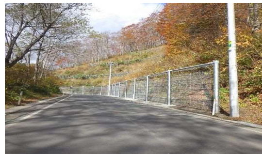
▲ せり出し防護柵の整備 〔(国)347号 鍋越（加美町）〕
